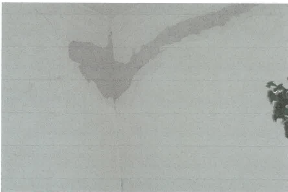
Fotografia nr 10 – widok rys, pęknięć, szczelin ubytków tynku ściany porzeczej w mieszkaniu
