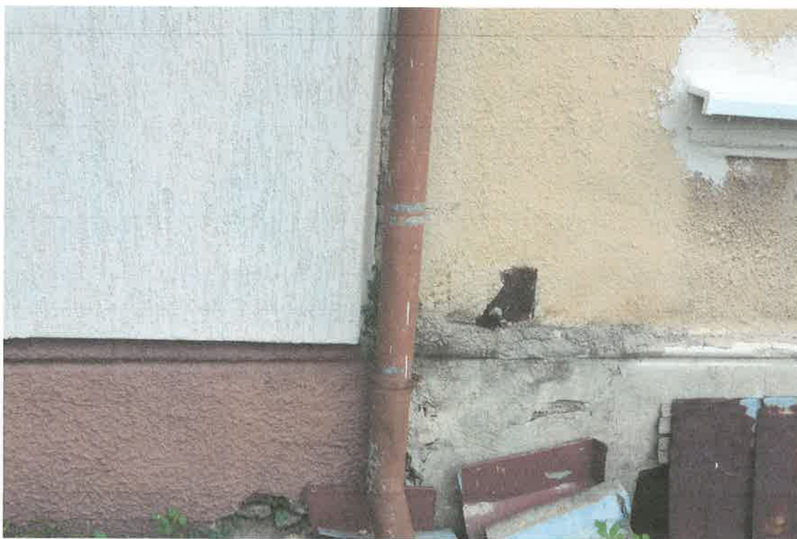
Fotografia nr 3 – widok nieszczelności rur spustowych wód opadowych budynku mieszkalnego
