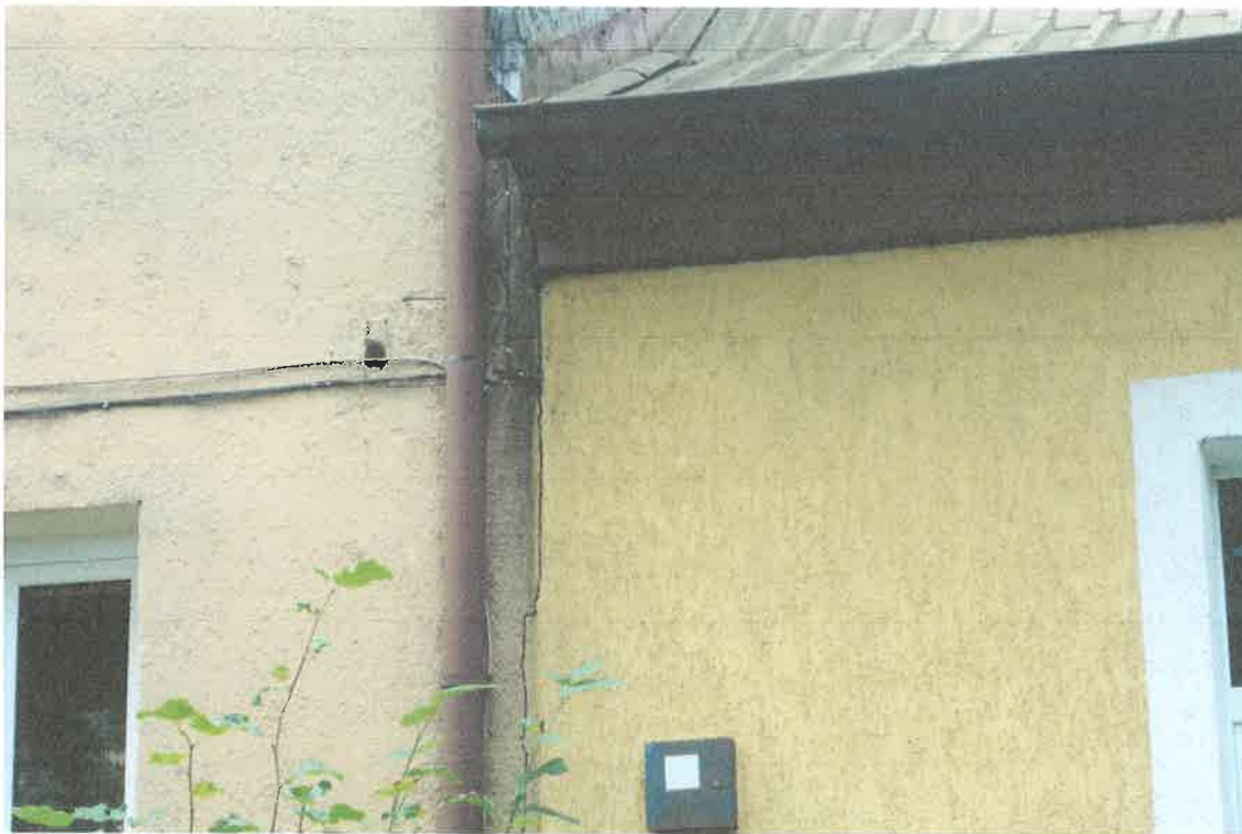
Fotografia nr 7 – widok rys, pęknięć, szczelin ubytków tynku ścian porzecznych na styku dwóch brył
