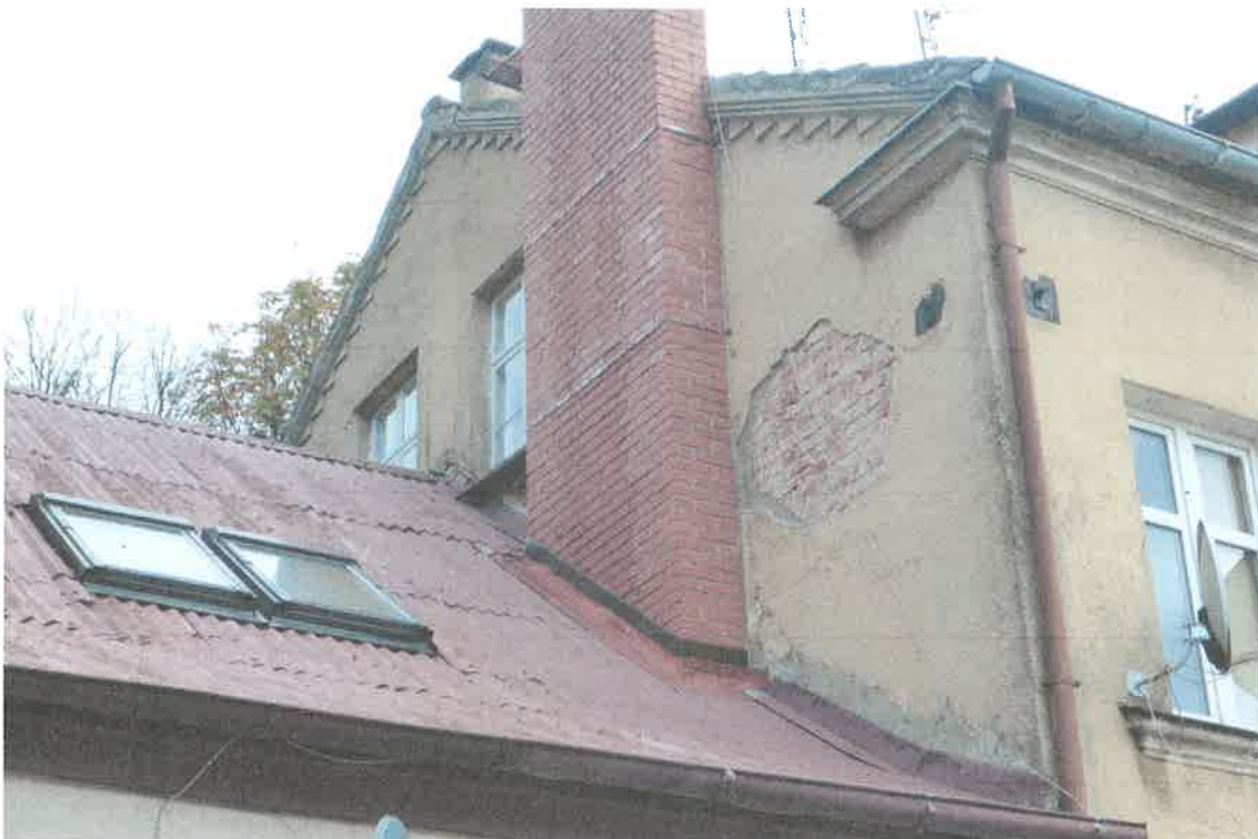
Fotografia nr 2 – widok rys, pęknięć ścian ubytków tynków na elewacji budynku
