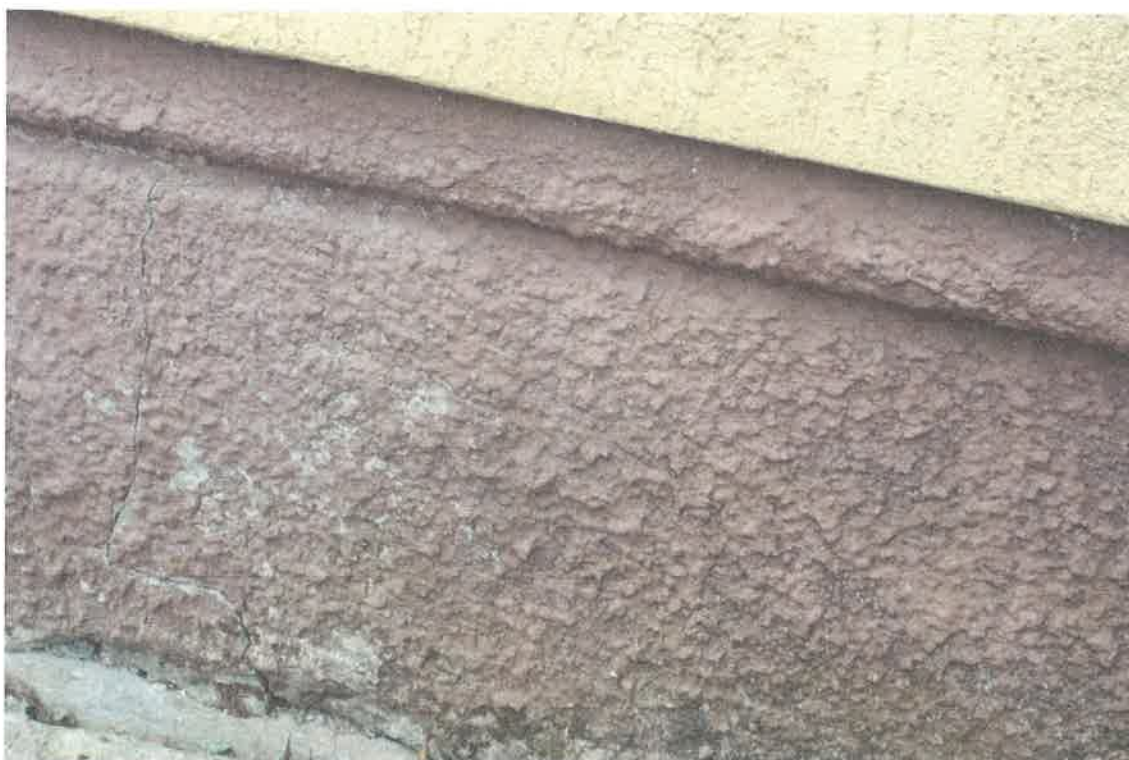
Fotografia nr 12 – widok rys, pęknięć, szczelin tynków cokolu w budynku
