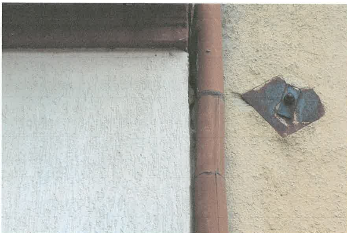
Fotografia nr 4 – widok nieszczelności rur spustowych wód opadowych budynku mieszkalnego
