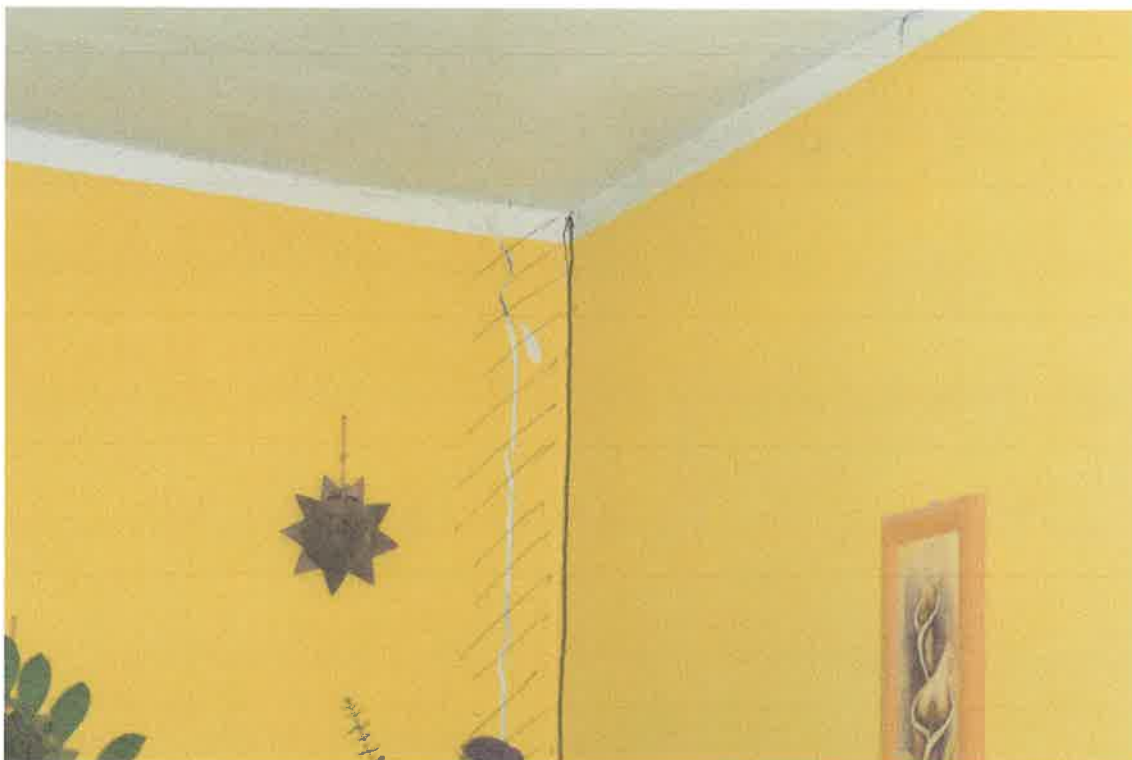
Fotografia nr 8 – widok rys, pęknięć, szczelin ubytków tynku ściany porzecznej w mieszkaniu
