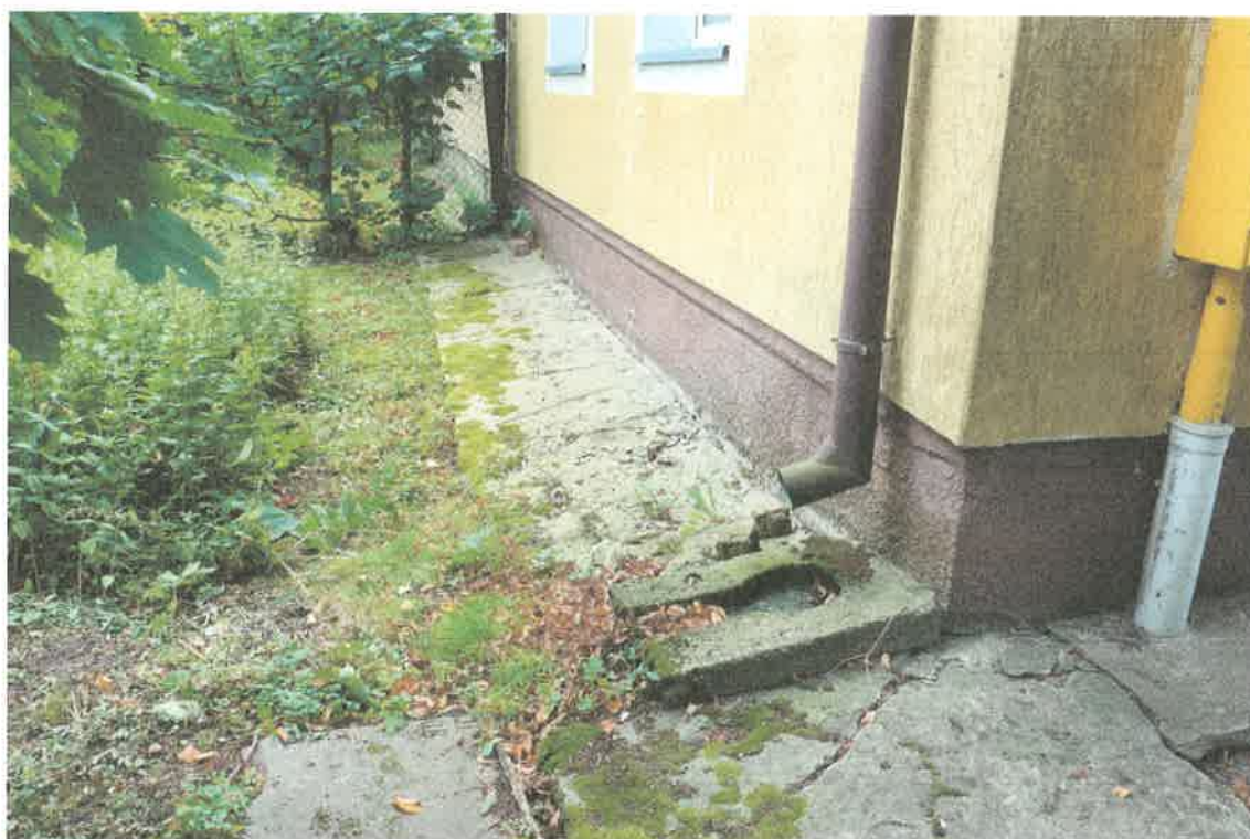
Fotografia nr 14 – widok rys, pęknięć, szczelin opaski betonowej budynku
