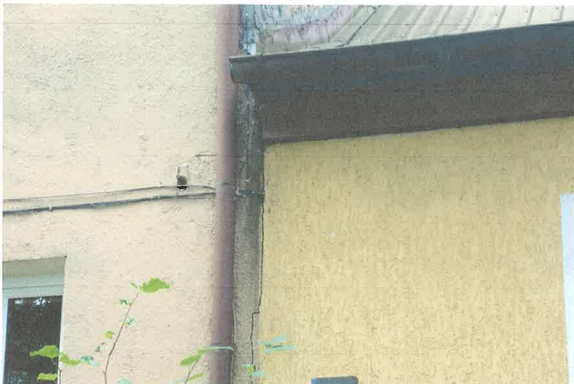
Fotografia nr 5 – widok rys, pęknięć, szczelin ubytków tynku ścian porzecznych na styku dwóch brył
