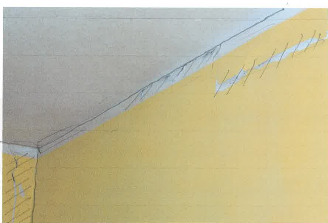
Fotografia nr 9 – widok rys, pęknięć, szczelin ubytków tynku ściany porzeczej w lokalu mieszkalnym
